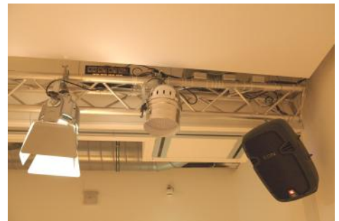
Ton, LED und Halogenbeleuchtung an der Traverse
